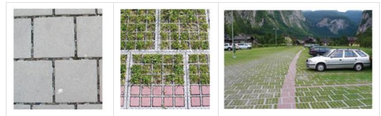
Pavimento permeable por junta y mediante celda. Fuente: Guías de adaptación al riesgo de inundación: SUDS. MITECO. Octubre 2019
