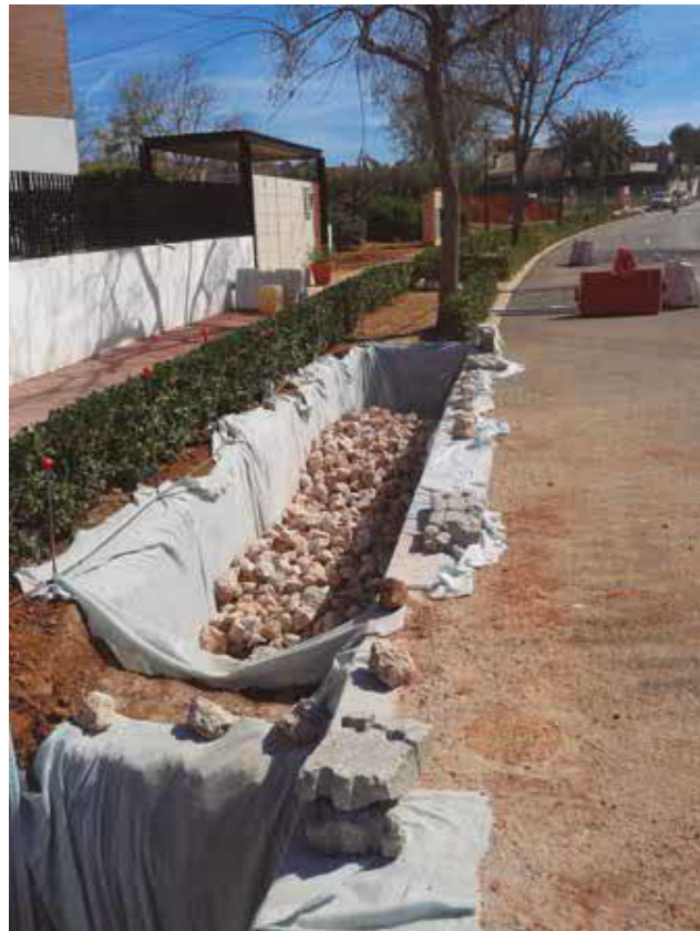
Cunetas filtrantes en calle Cotoliu
