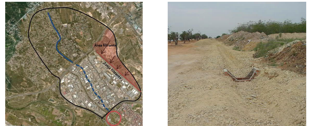
Figura 48. Área y zanja filtrante.
