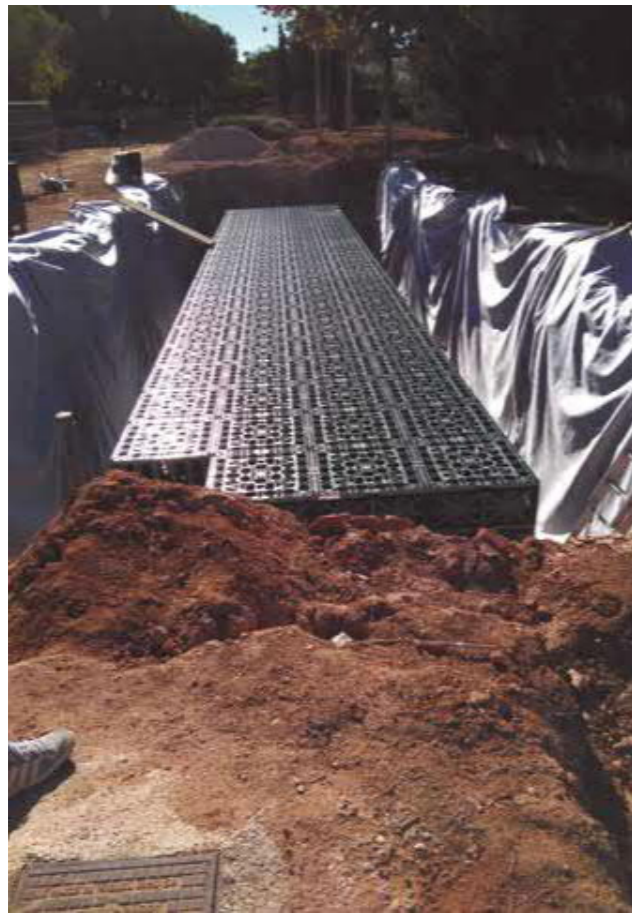
Depósito en Mas Camarena: bloques de infiltración
